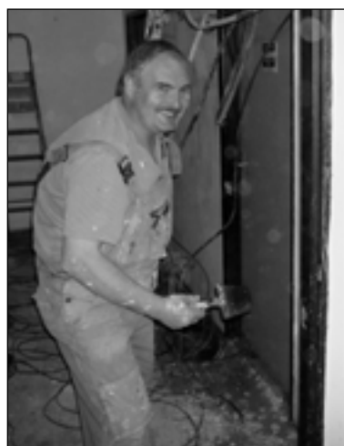
Výměnu elektroinstalace na úřadě provádí Ivo Kaminský ze Sýkořice. Foto Petr Tříška
