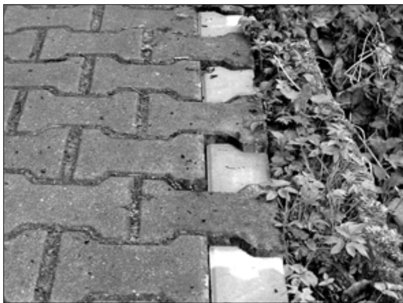
Zmizelá zámková dlažba byla provizorně zpevněna jiným typem, to aby nedocházelo k dalšímu rozpadání chodníku. Foto Milan Bednařík
